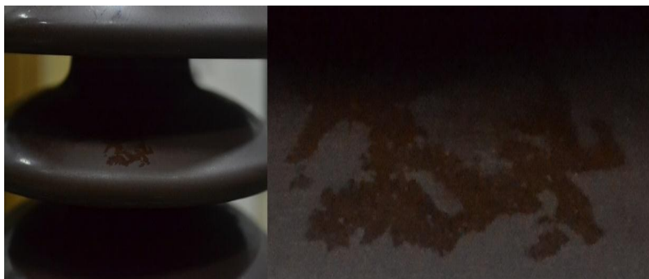
ภาพที่ 18 การเปลี่ยนแปลงบนผิวลูกถ้วยฉนวน
