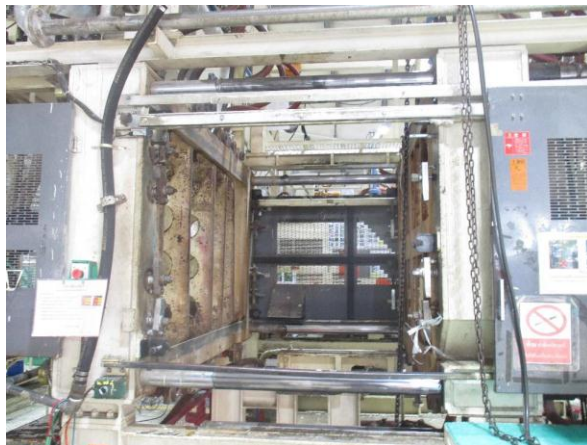
ภาพที่ 1 เครื่องจักรที่ยังไม่ได้ติดตั้งอุปกรณ์ป้องกันอันตราย
